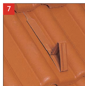
SIGURNOST NA KROVU
